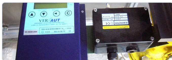
VERIBOX-MINI an einer Gasleitung, Gehäuse plombiert
