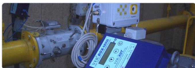
Gasmessstelle: VERIBOX-MINI am Mengenumwerter
